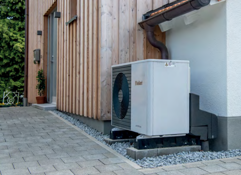
Die entstandene Nische bot sich für das Außengerät der Wärmepumpe an.
