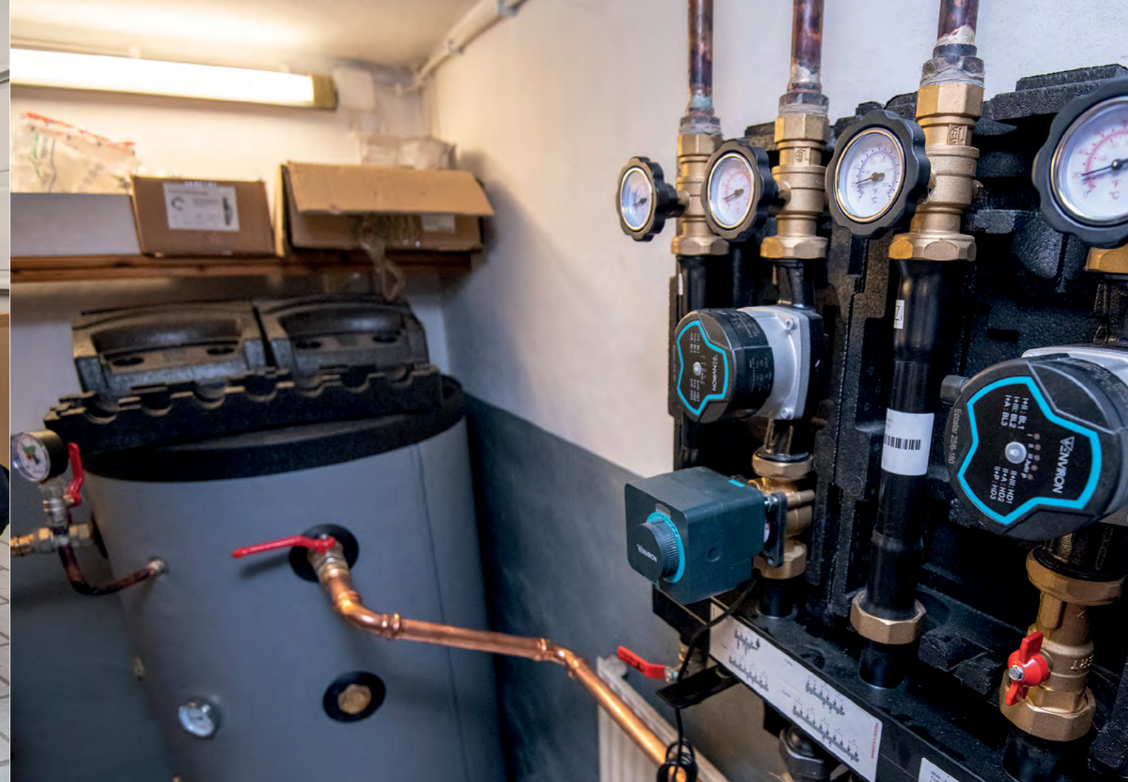
Dreh- und Angelpunkt der Heizung ist der Pufferspeicher. Links die getrennten Heizkreise für Erd- und Obergeschoss.
