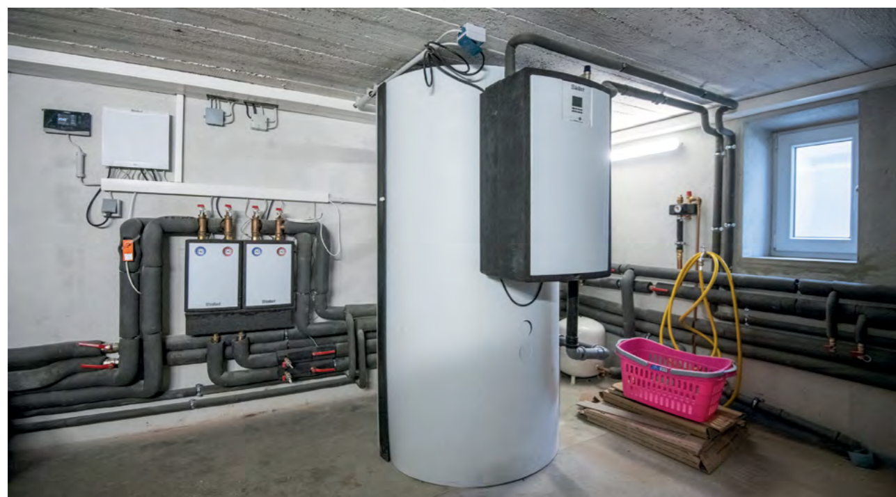
Keller mit Trinkwasserstation am Pufferspeicher. Im Hintergrund an der Wand: die Hydraulikstation.
