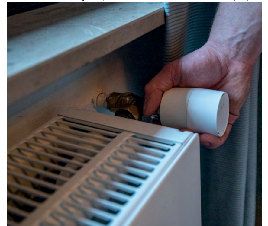
Dreilagige Heizkörper sorgen im Obergeschoss für eine größere Heizungsoberfläche. Ideal für niedrige Temperaturen in Kombination mit der Wärmepumpe.
