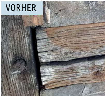
Risse und Spalten im Holztragwerk
