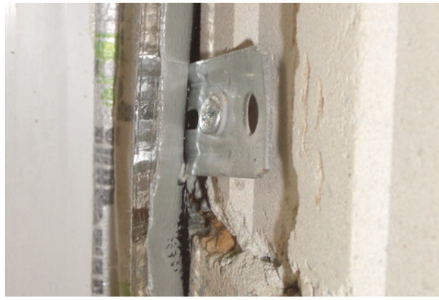
Mangelhafte Ausführung der Luftdichtheitsschicht. Fehlstelle an der Befestigungslasche, das Klebeband haftet nicht an der unverputzten Wand durch fehlenden Haftgrund.
