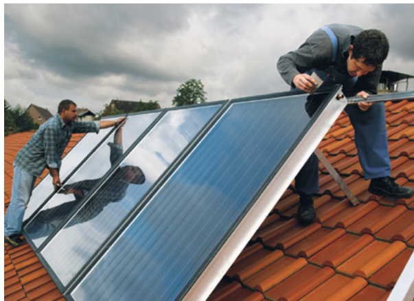
Installation von Flachkollektoren auf einem Satteldach. Die Kollektoren werden mit einer Aufständerung montiert, um einen steileren Aufstellwinkel zu erreichen.
