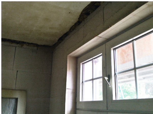
Innendämmung aus Mineralschaumplatten mit Dämmung der Fensterleibungen
