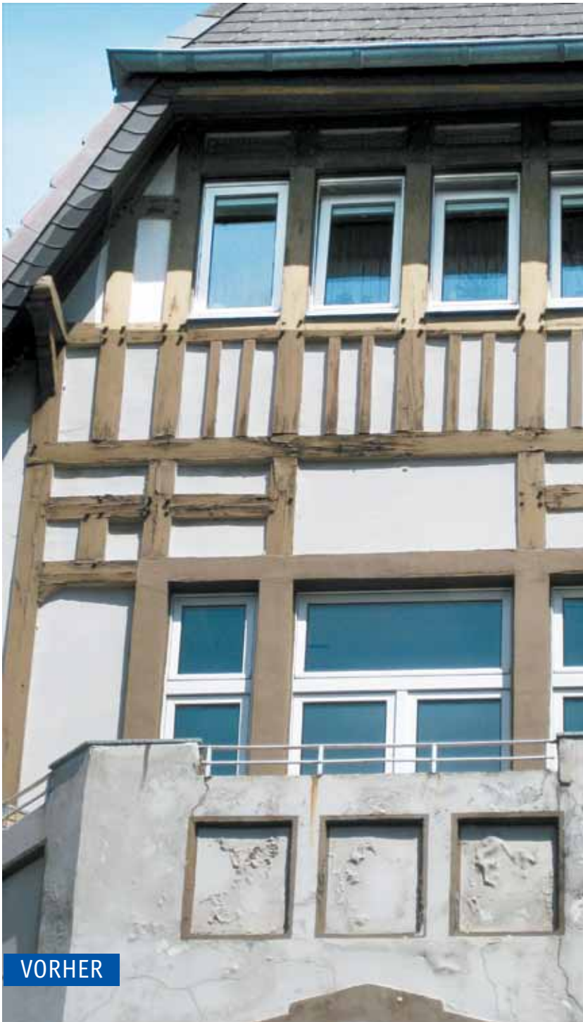
Morsche Balken und undichte Balkonabdichtung hatten die Fassade im Laufe der Zeit arg mitgenommen.
