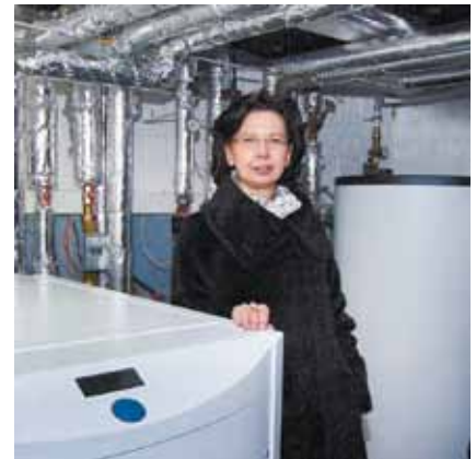
BHKW im Keller und Feng Shui in der Gestaltung – hier als ein Erfolgskonzept.
