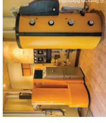
Pelletheizkessel mit Puffer-/Schichtspeicher mit Solarthermieeinbindung und Frischwasserstation.
