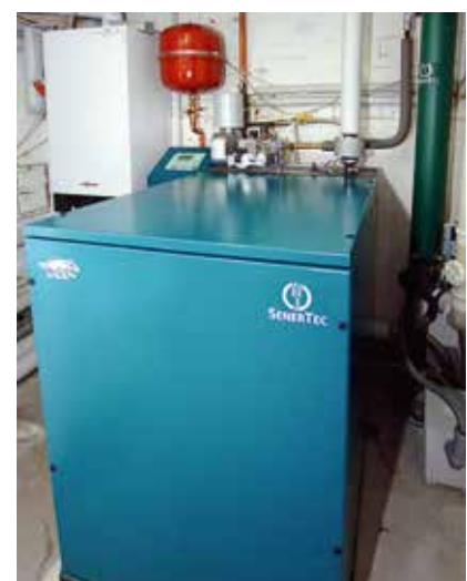
Das BHKW erzeugt gleichzeitig Strom und Wärme.
