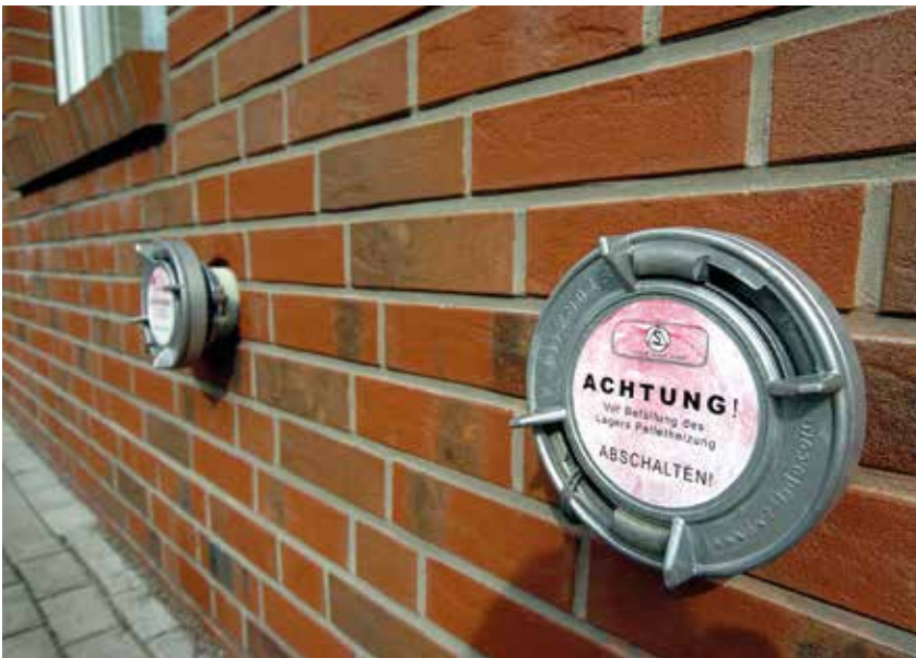
Einfüllstutzen und Absaugvorrichtung für Pelletlieferungen.
