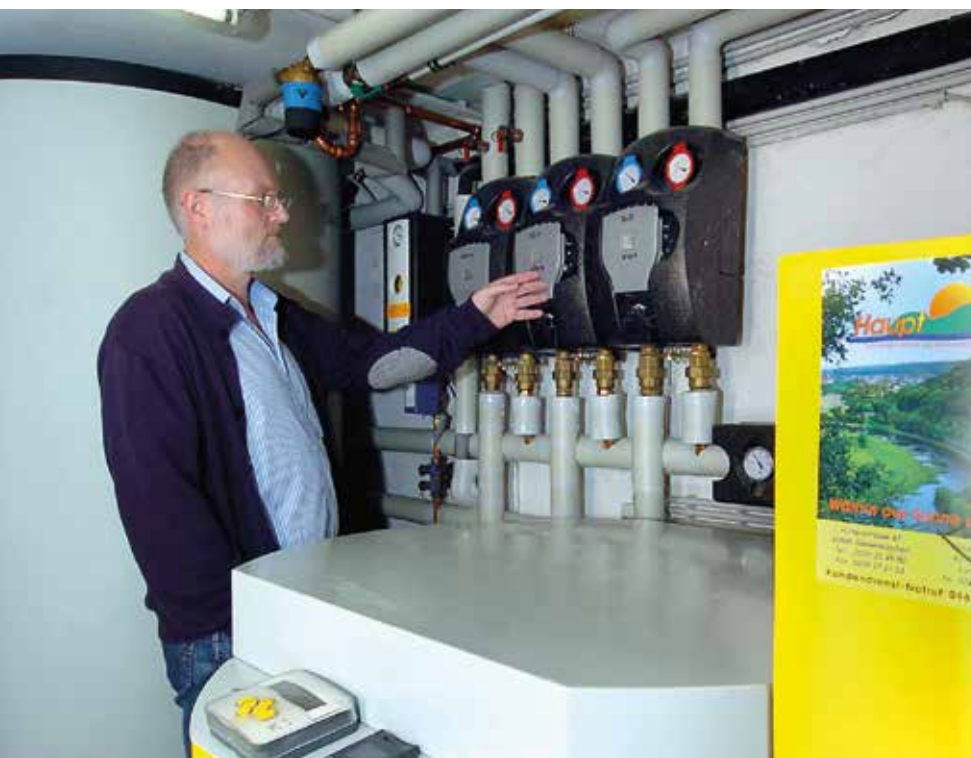
Der Pelletofen liefert Heizwärme und warmes Wasser, zudem wird er solarthermisch unterstützt.
